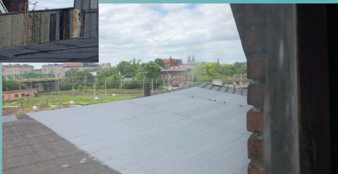
Naprawa dachu hali wachlarzowej nad ekspozycją Stowarzyszenia wykonana przez PKP SA - 2019 rok
